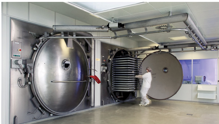
Frysetørningsanlæg. Foto: GEA's hjemmeside.
